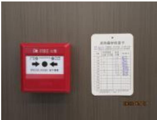
fire alarm button.JPG
